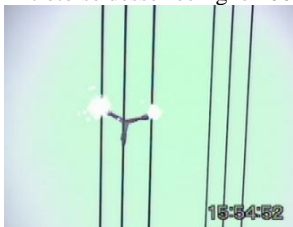
Entretoise desserrée ligne 400 kV
