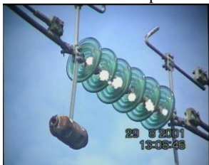
Isolateur 90 kV avec pollution saline
